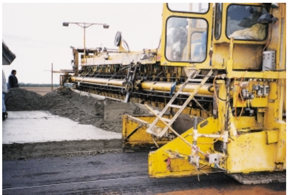
Bild 13: Einbau des auf den verdichteten Unterbeton geförderten Oberbetons durch den Oberbetonfertiger, der hier für den späteren Anbau einer Verzögerungsspur mit Seitenabschaltung fährt.
