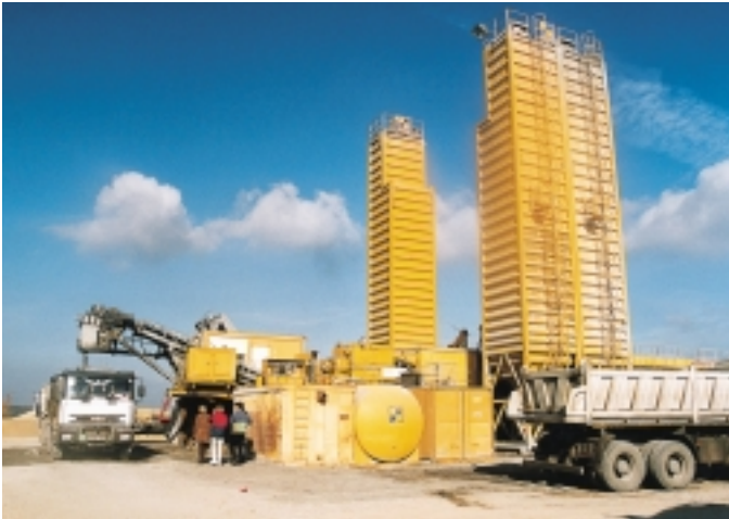
Bild 8: Kontinuierlich arbeitende Betonmischanlage (Leistung rd. 200 m 3 /h)
