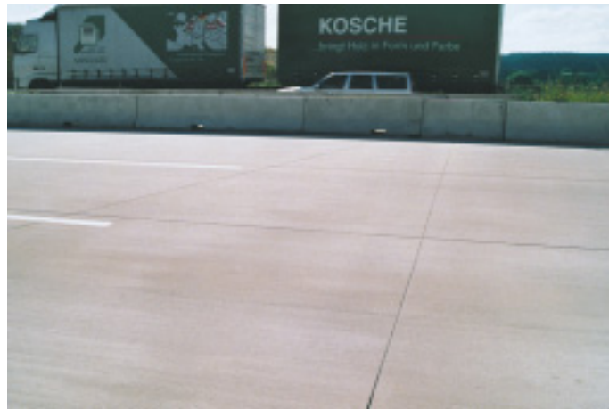
Bild 6: Schiefwinkelige Querscheinfuge in einer Betondecke über dem Widerlager einer kurzen Brücke ohne Übergangskon- struktion
