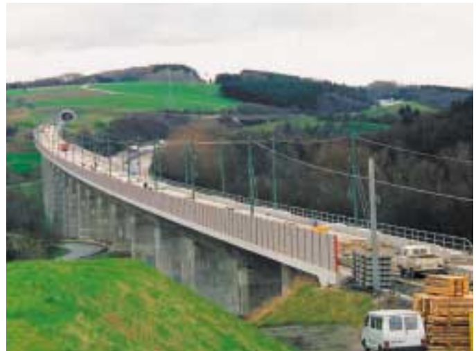
Bild 8: Im Zuge einer Festen Fahrbahn stellen Brücken zusätzliche Anforderungen an die Bautechnik
