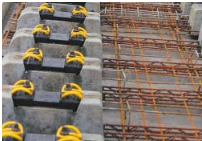
Bild 7: Die von WH VWB verwendeten Zweiblockschwellen mit Gitterträgern erhöhen den Verbund zwischen Füllbeton und Schwelle, hier: Zweiblockschwellen mit verlegter Füllbetonbewehrung auf einer langen Brücke
