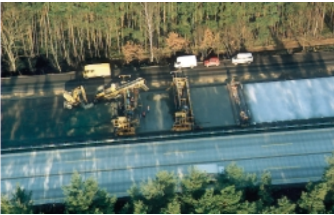
19: Einbau der Fahrbahndecke aus Beton mit einem Heilit + Woerner-Betondeckeneinbauzug auf der BAB A 2 bei Magdeburg
