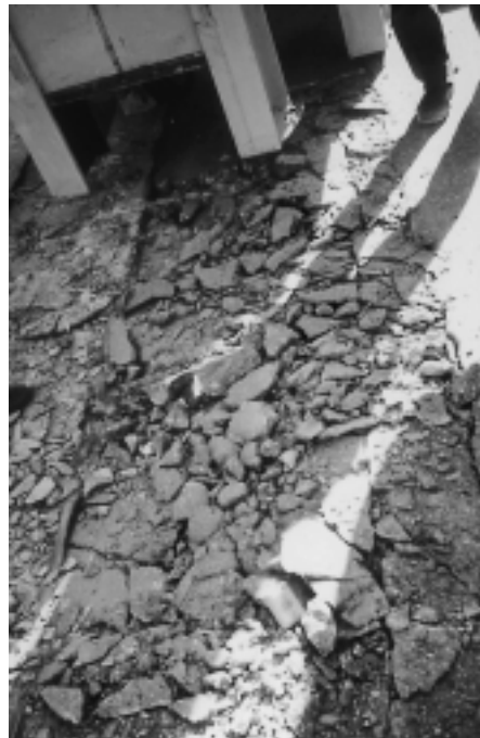
5: Der Grad der Zertrümmerung der alten Betondecke
