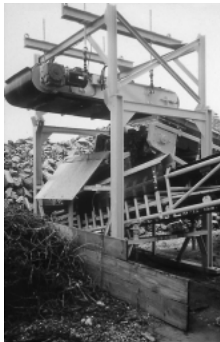
8: Mit Überbandmagnetabscheider wird nach dem Brechvorgang Stahl aus den Recycling-Mineralstoffen entfernt
