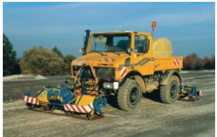
11: Neben Walzen eignen sich auch Anbau-Vibrationsplatten zum Verdichten und Nachverdichten der ToB
